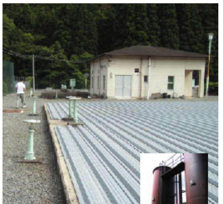
大原簡易水道第1浄水場
